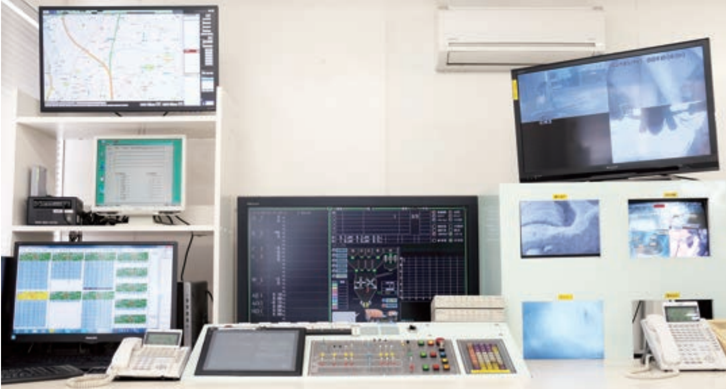
出荷管理装置及び主制御操作盤
